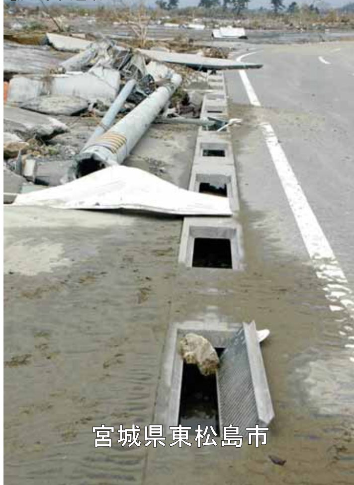
2007_2_018_009571_東松島市(広報)_2011.3.15 _洲崎市道沿い
