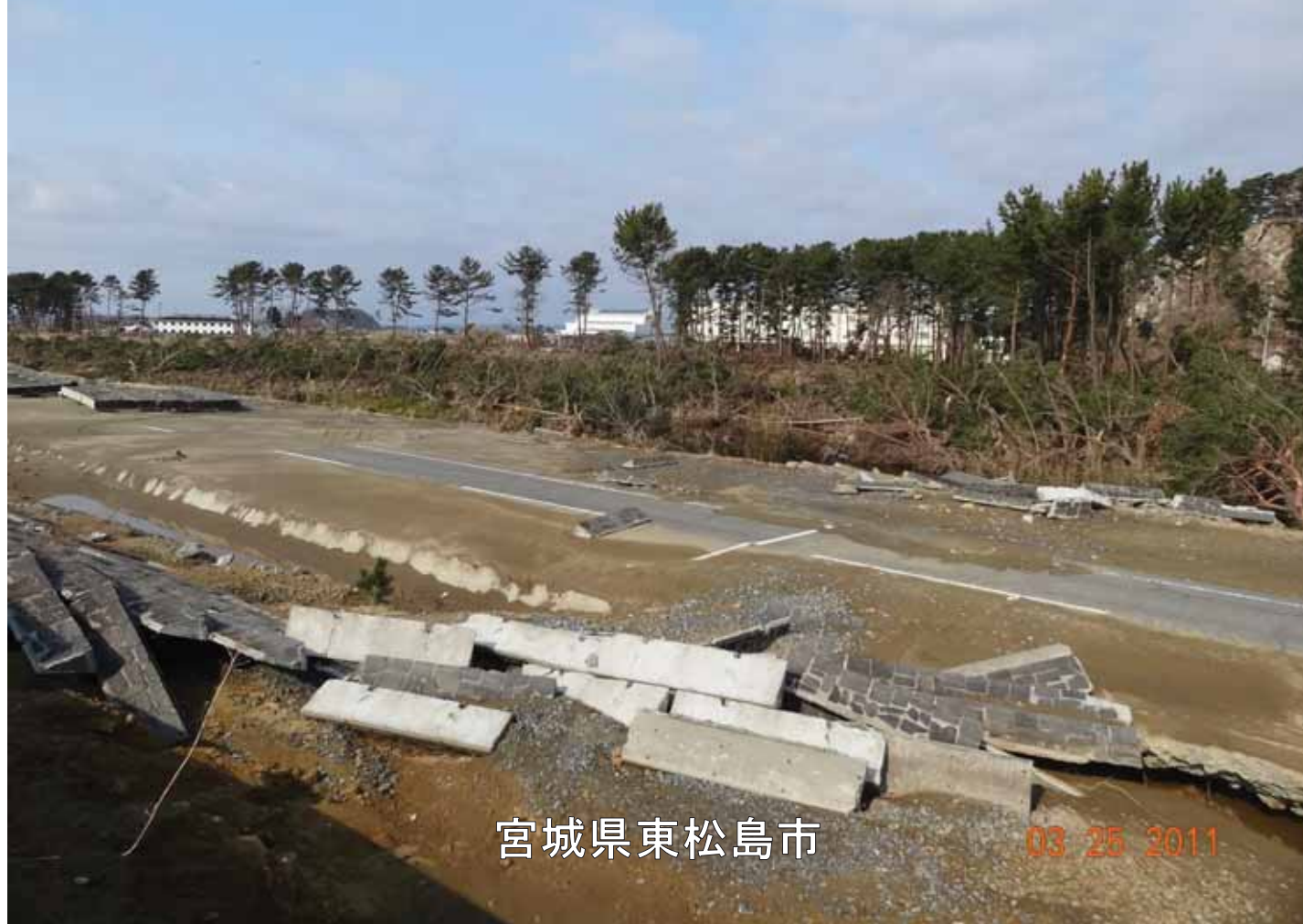
2001_2_033_042936_伊藤まさ子_2011.3.25_野蒜海岸_堤防_コンクリート壊滅
