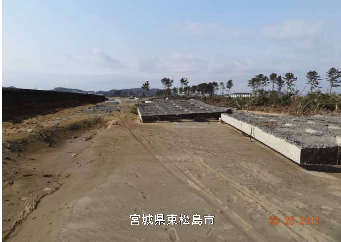
2001_2_033_042937_伊藤まさ子_2011.3.25_野蒜海岸_堤防_コンクリート壊滅
