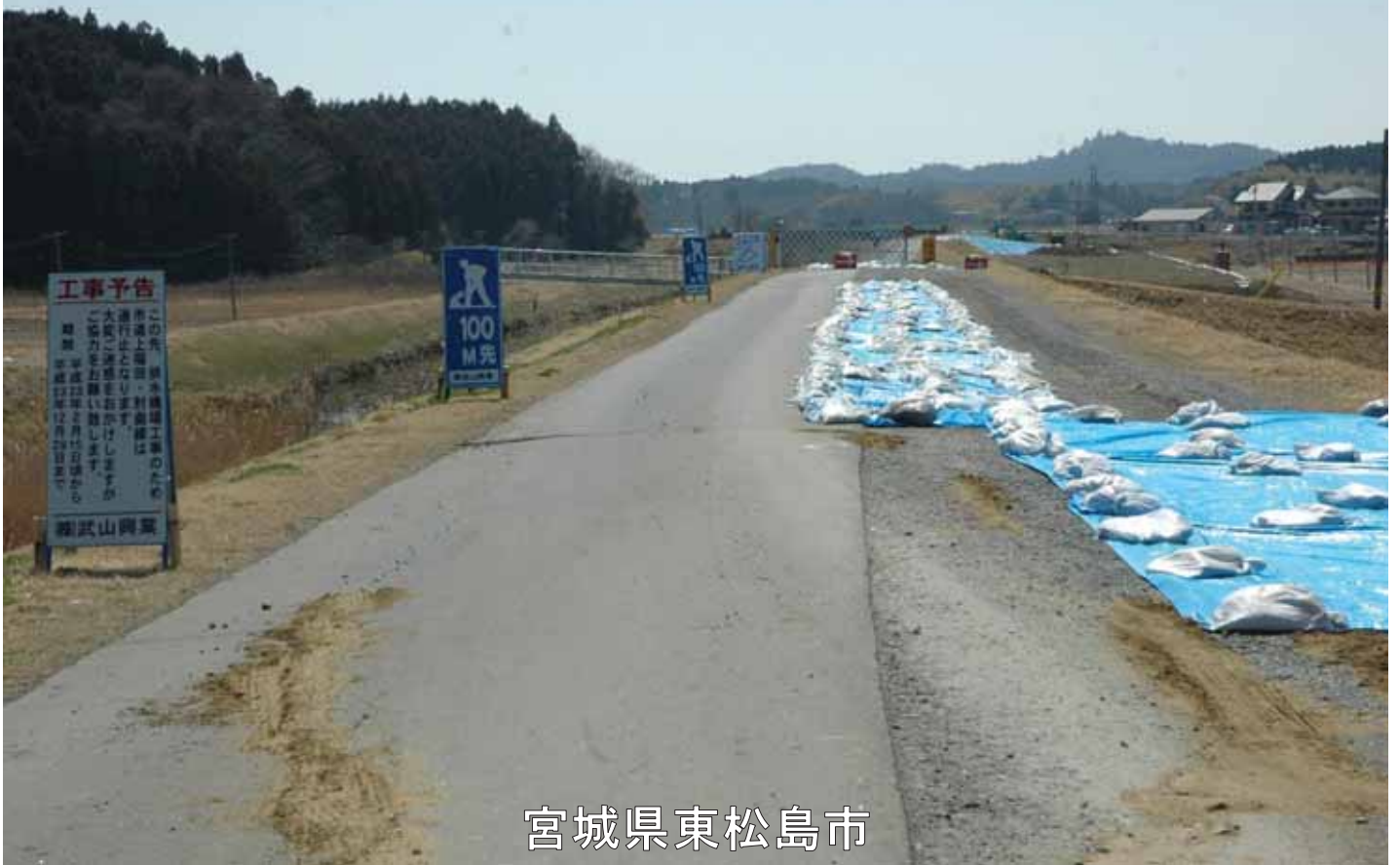
1309_2_018_013201_東松島市(広報)_2011.4.1_鞍坪川堤防(西福田堀切・排水機場南側)
