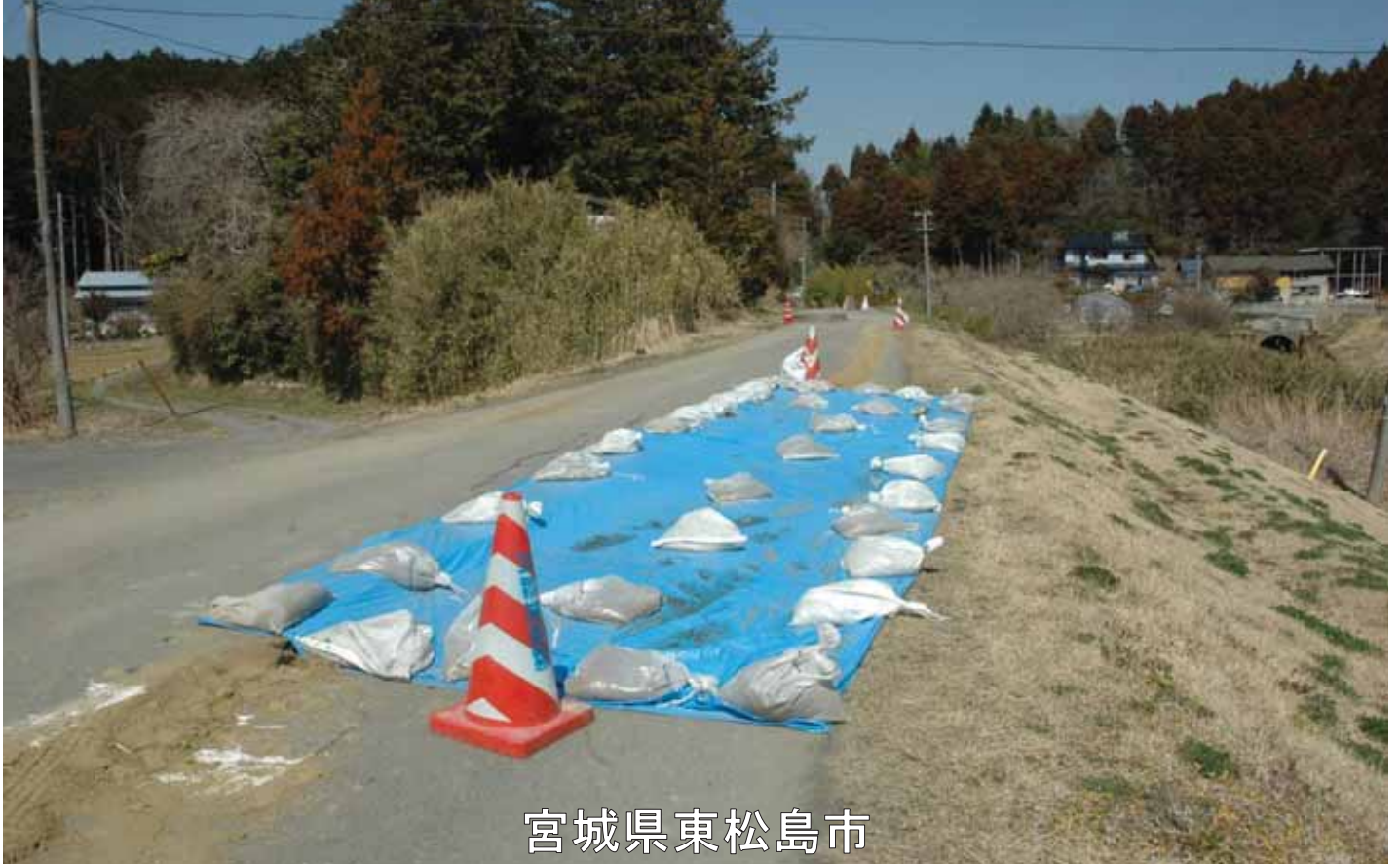
1309_2_018_013202_東松島市(広報)_2011.4.1_鞍坪川堤防(西福田堀切・排水機場南側)
