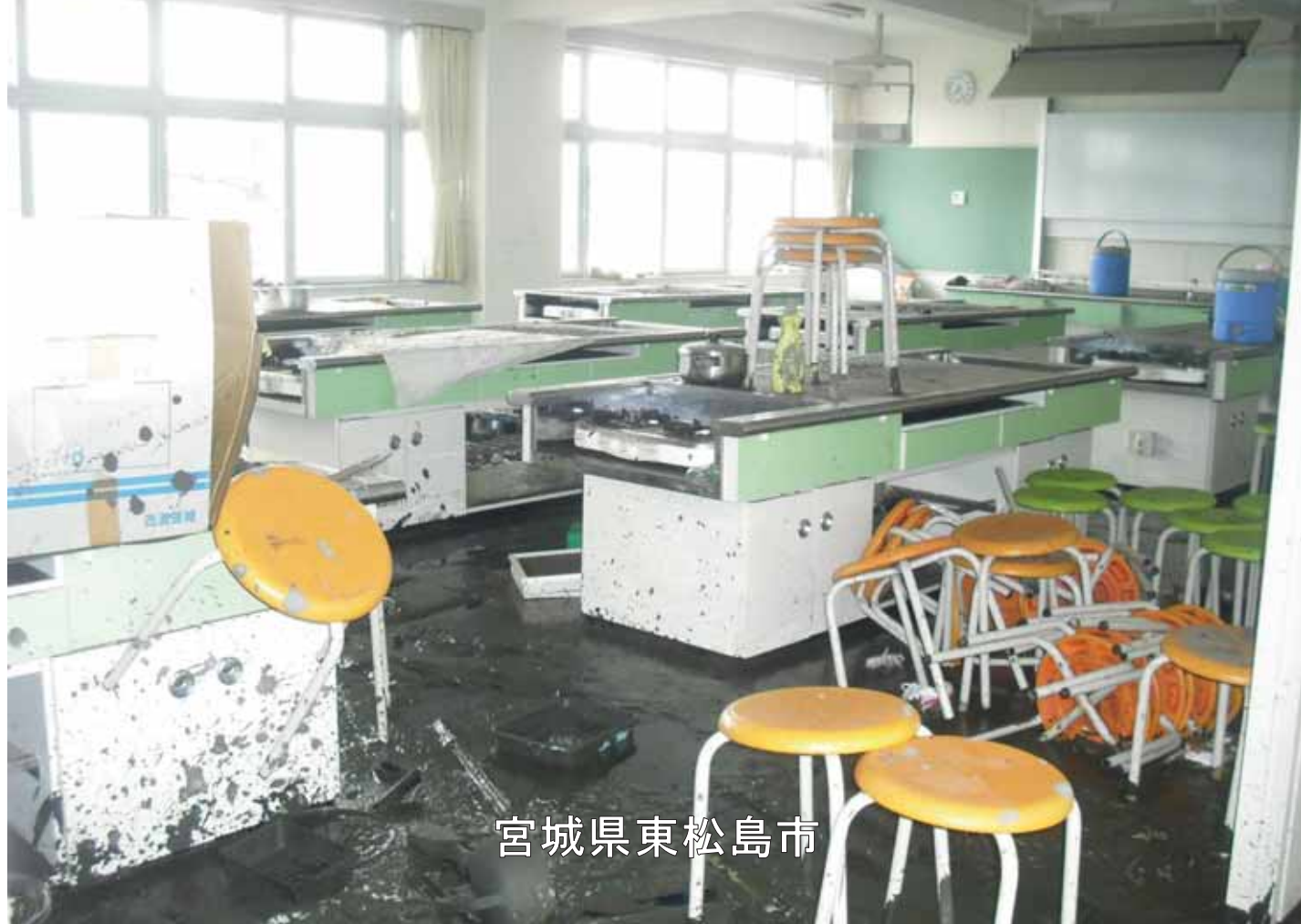
0818_2_018_020063_東松島市_2011.3.20_校舎1階_被害
