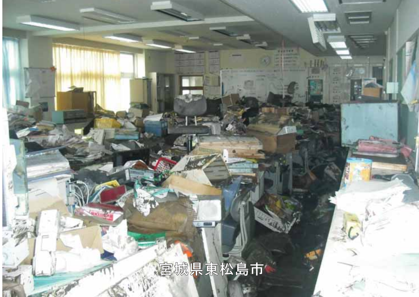
0818_2_018_020064_東松島市_2011.3.20_校舎1階_被害
